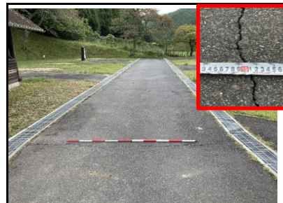
写真15 路面のクラック
