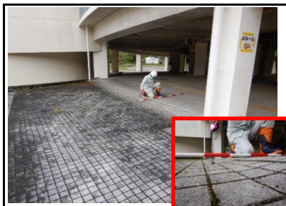
写真10 舗石タイルの沈下
